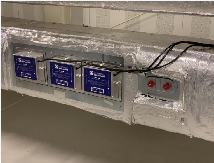
Instalacja kanałowa w maszynowni — praca 24/7
