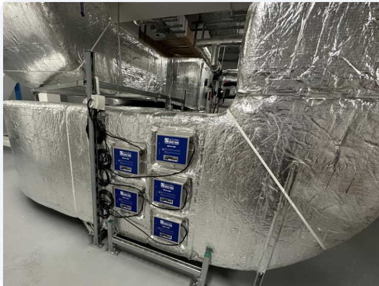
Powietrze: moduły INDUCTmed w kanałach HVAC — polski szpital
